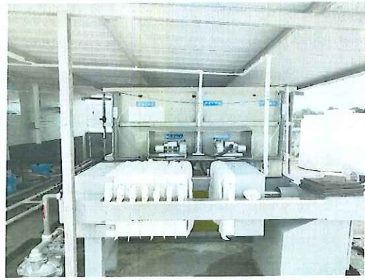
工业废水处理设施相片
