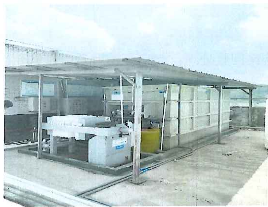
工业废水处理设施相片
